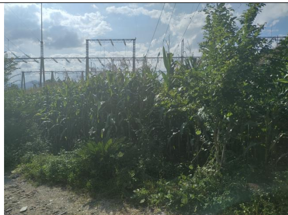
110kV 七拱站进线侧
